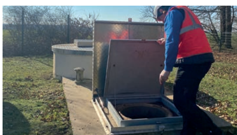
Station de pompage à Hadancourt-le Haut Clocher
